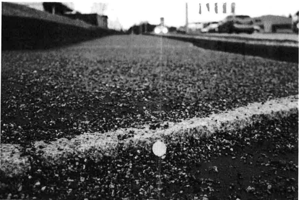
Skarp og for høy kantstein i overgang mot kryss i Novikveien litt før Rema 1000. Mynten er en 20-kr.
